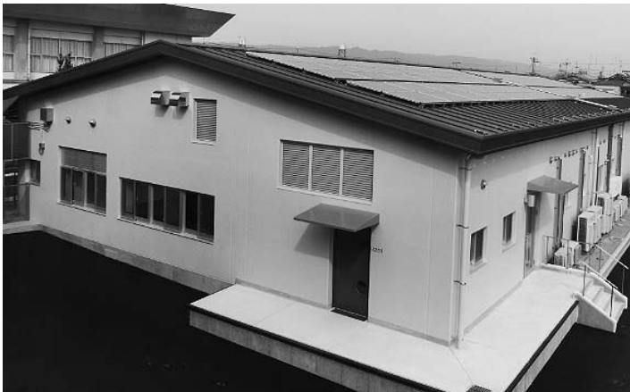
給食室の電力を賄う太陽光発電パネル
